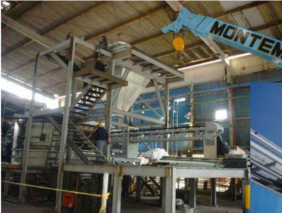
Estructura y Tolva de Materia Prima
